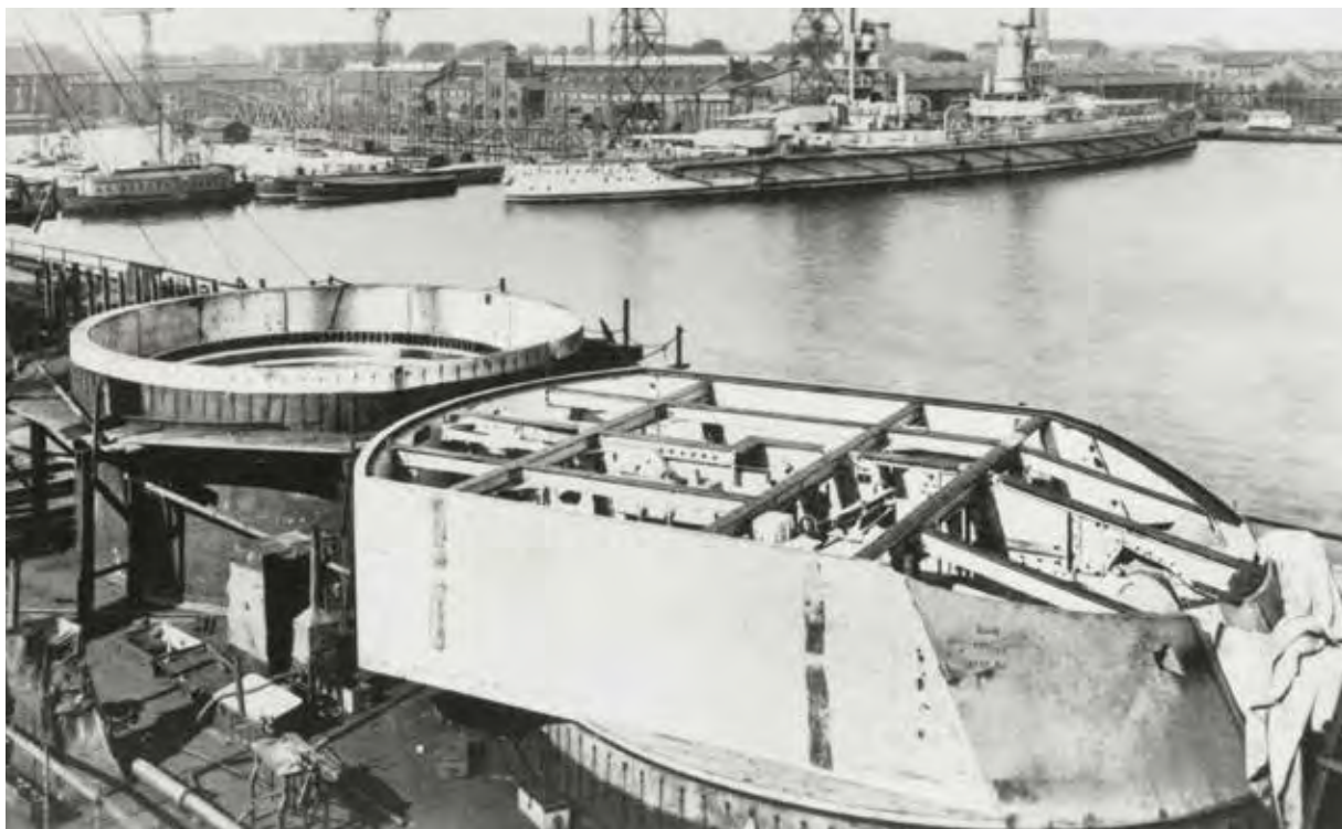
SMS KAISERIN im Bau in Kiel befindlich, mit Blick auf den oben noch offenen Turm und in eine Barbettes mit Drehkranz.
